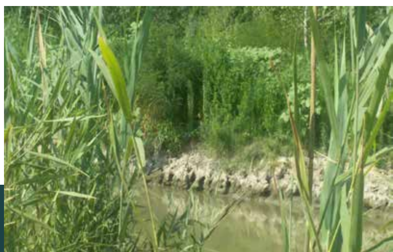
Sponda di un canale danneggiata dalle tane del gambero
